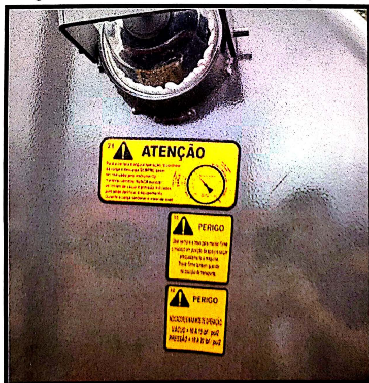
Figura 06: Foto da sinalização existente no equipamento
