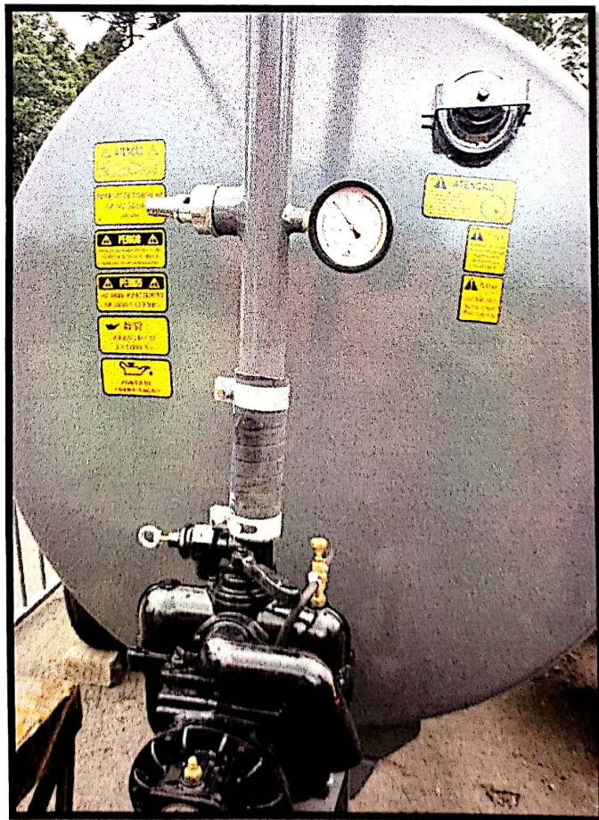
Figura 08: Foto da sinalização existente no equipamento
